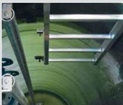
Встроенная лестница для техобслуживания
